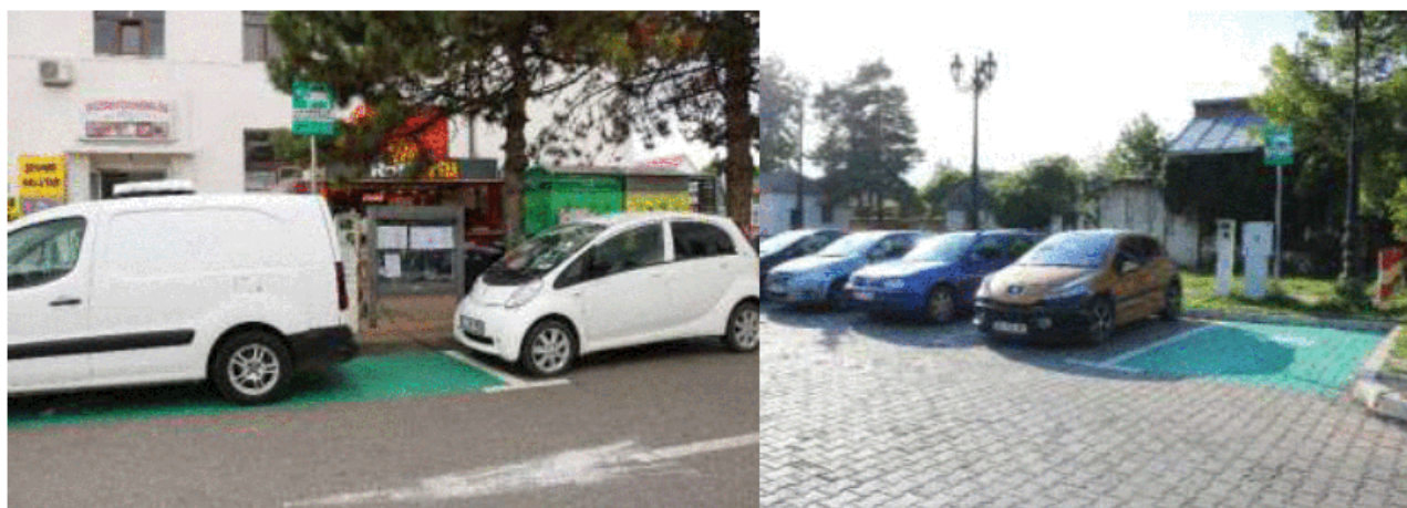
Figura 2.118. Stații de încărcare a vehiculelor electrice (exemplificare).
